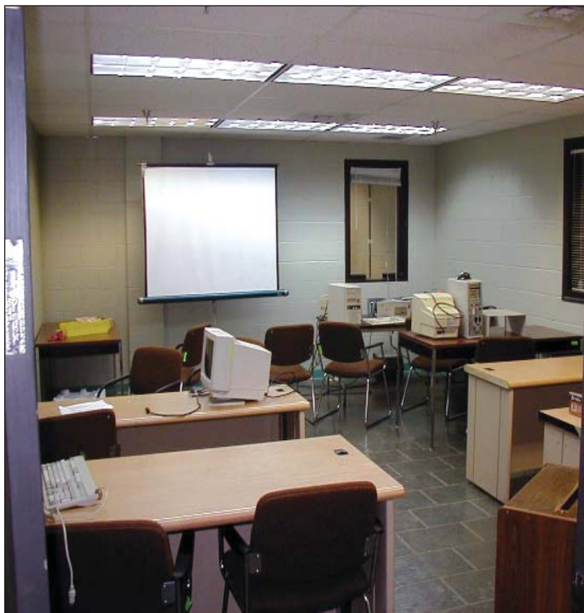
Affollamento degli edifici e vie di uscita, ascensori di tipo protetto, impianti di spegnimento garantiscono la sicurezza negli uffici. A tal proposito si possono notare degli sprinkler posizionati tra le plance dell'illuminazione della sala
